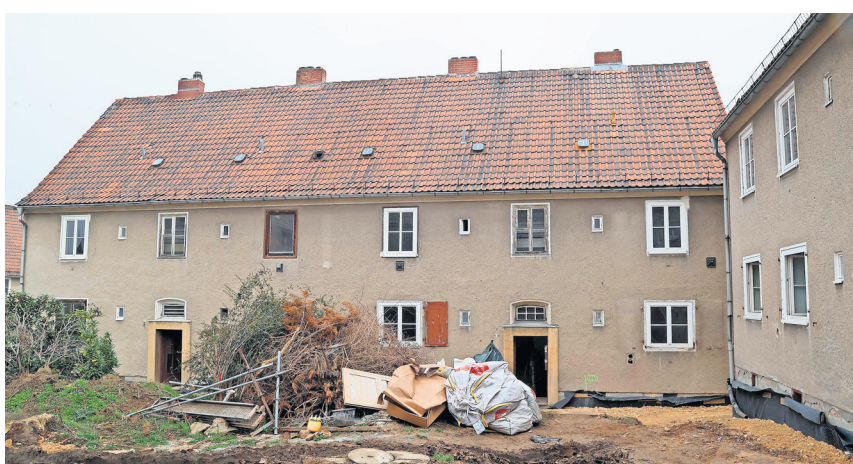
So sieht der Zustand vor der Sanierung aus. FOTO: MARIO JAHN
