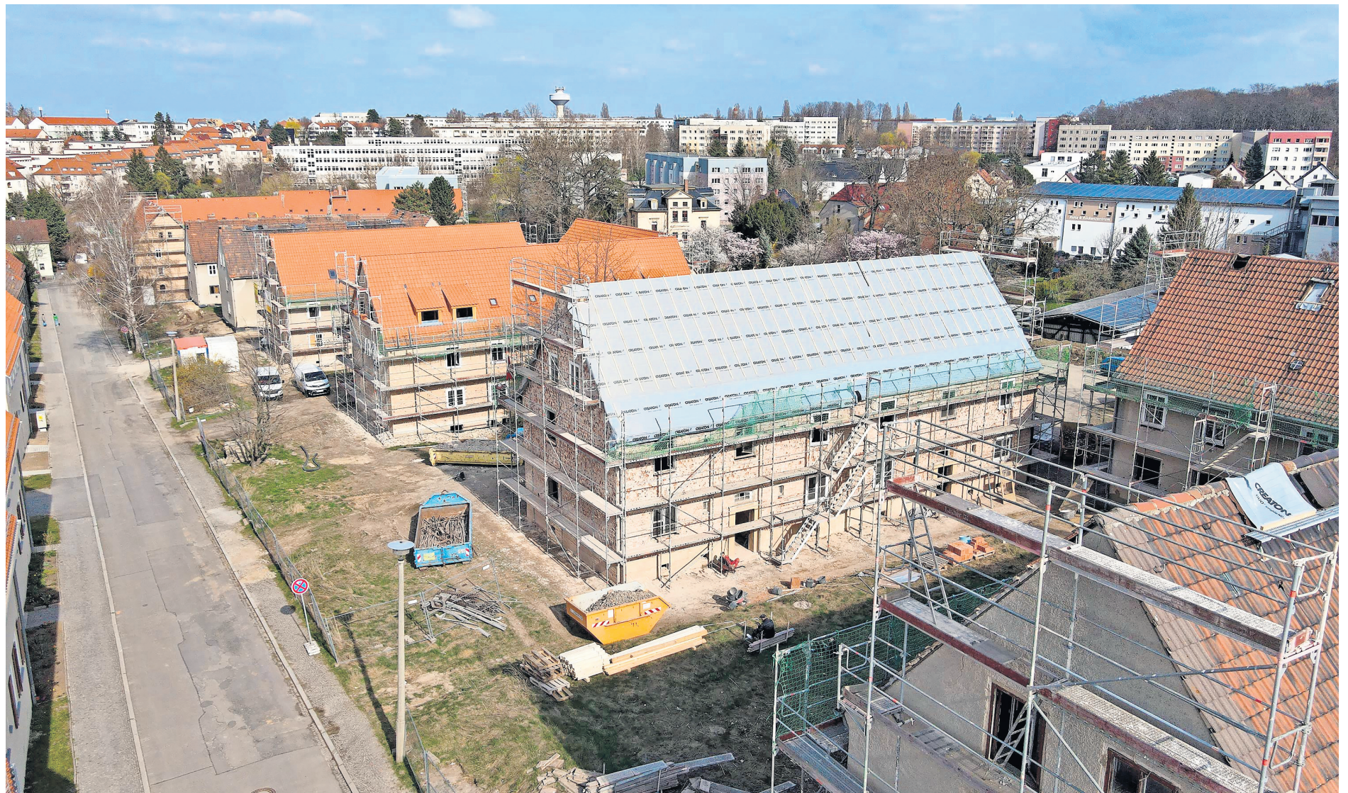
Während Bauprojekte andernorts auf Eis gelegt werden, läuft die Sanierung eines Großteils der früheren Gagfah-Siedlung in der Altenburger Südstraße auf Hochtouren. FOTO: MARIO JAHN
