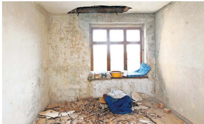
Durch Nasseschäden, jahrelangen Leerstand und Pfusch beim Bau anno 1893 gibt es in dem Haus Einsturzzone.
