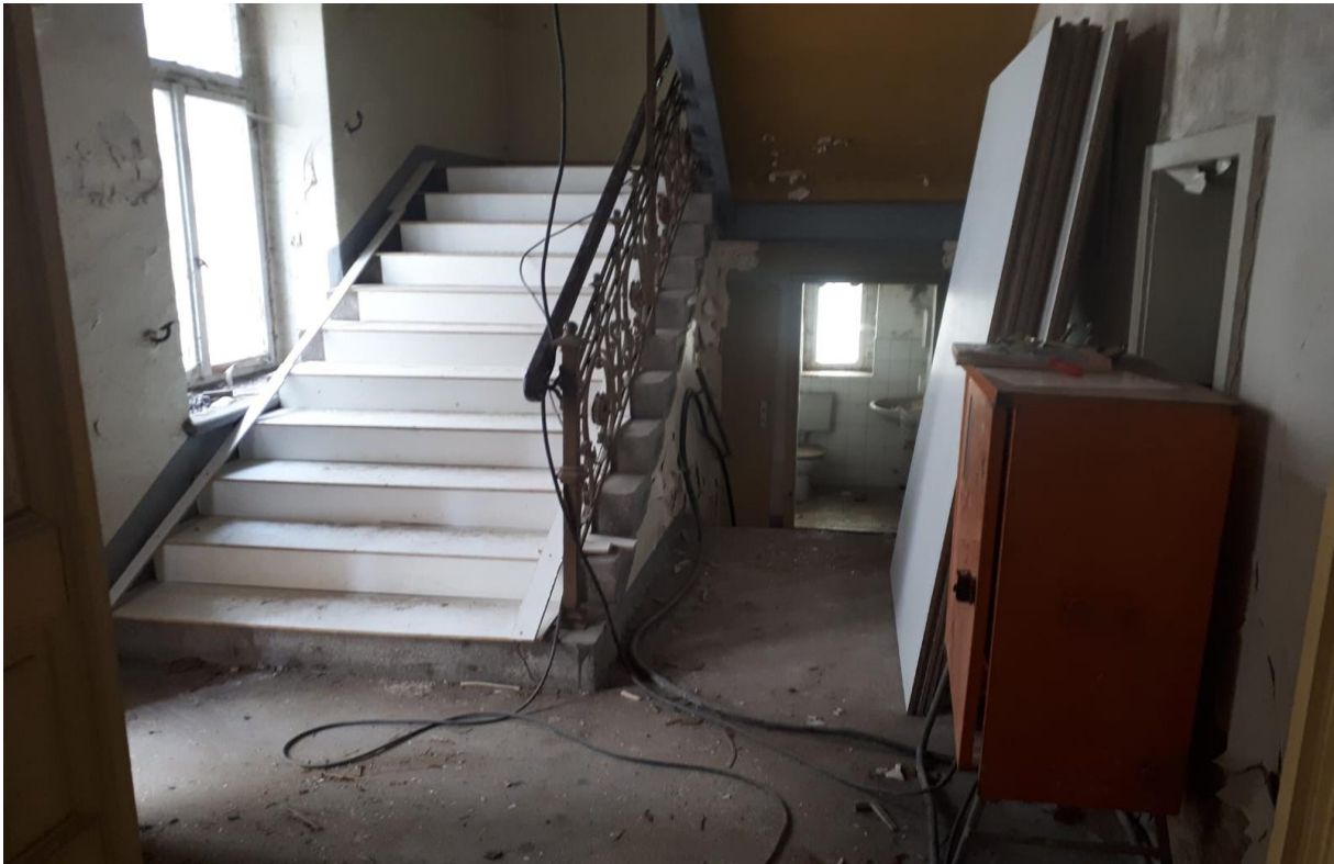
Baustromverteiler im Eingangsbereich des Treppenhauses
